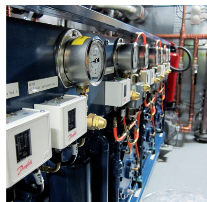
Холодильная техника управляется оборудованием Danfoss
